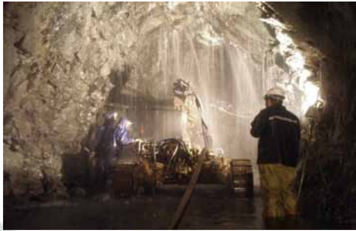
頭水隧道橫坑上方滲水嚴重
